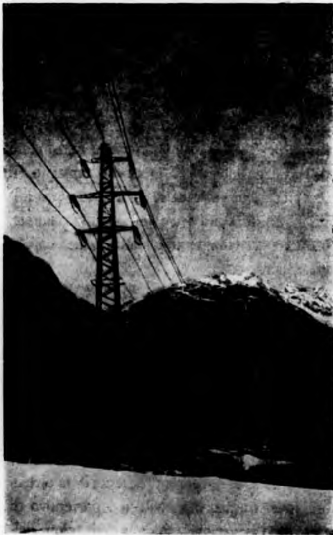
Linea elettrica Ronone-Torino a 90.000 V. Palo normale
